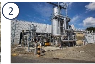
2 Aminwäsche (nach Biogas-Anlage)
