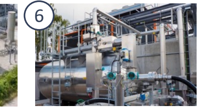
6 Versorgung Fischer-Tropsch SAF-Anlage (Atmosfair)
